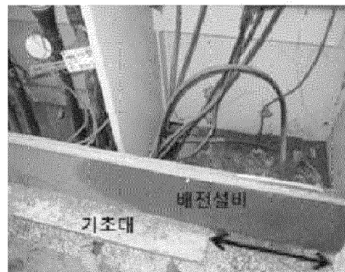
지상변압기 일반형 3상 75kVA (기초대가 작아 앵커기초 미설치)
