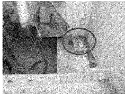
지상변압기 일반형 1상 50kVA (앵커기초 시공불량)
